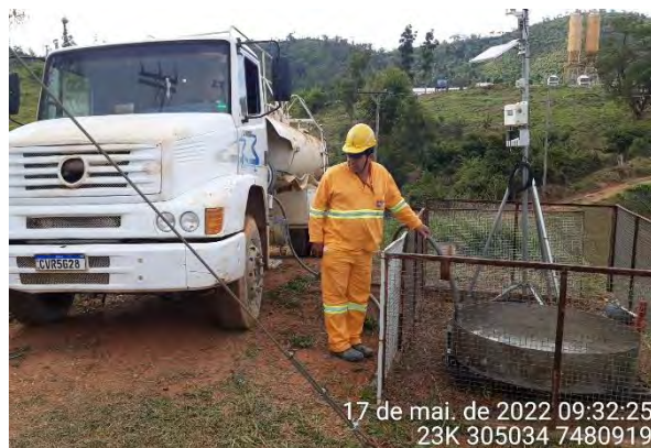
Foto 2 – Tanque do reservatório sendo preenchido com água. (Data: 17/05/2022).
