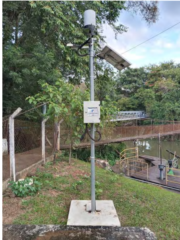
Estação Telemétrica Limpa (perto)
