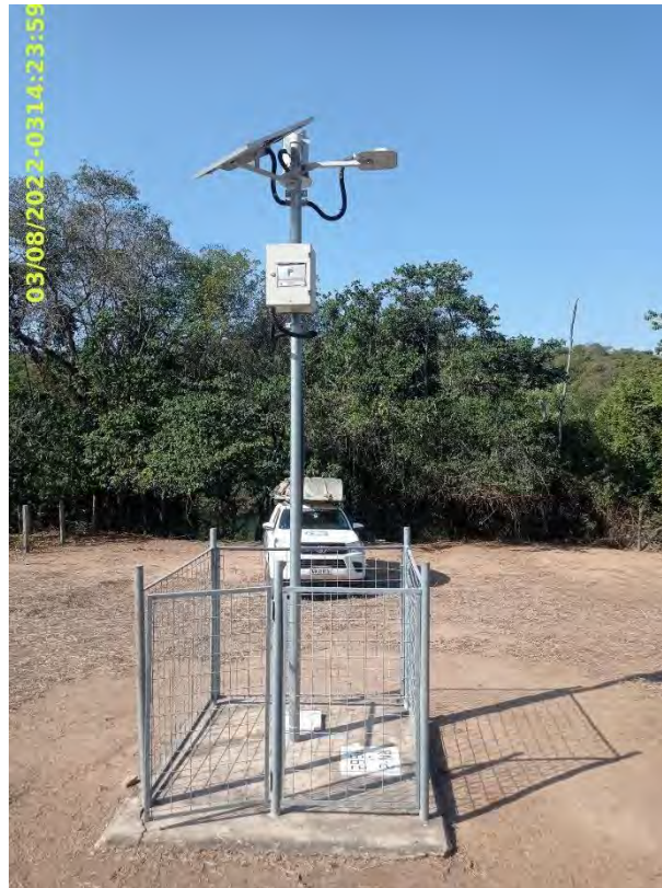
Estação Telemétrica Limpa (perto)
