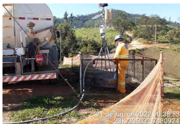
Foto 4 – Tanque do reservatório sendo preenchido com água. (Data: 21/06/2022).
