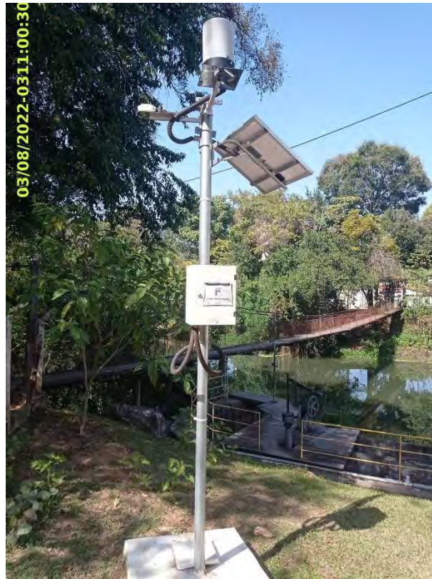
Estação Telemétrica Limpa (perto)
